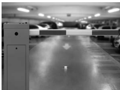
Шлагбаум, управляемый ПЧ ATV 12
