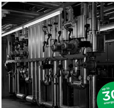
Управление насосной станцией
