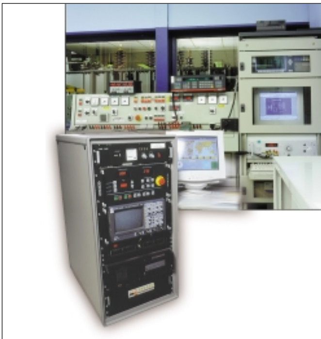
Пульт управления испытательного стенда
